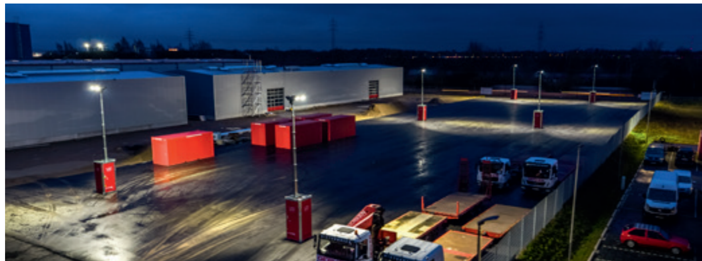
▼ Lichtmast-Technik 2018: Extrem sparsame LED-Leuchtmittel ermöglichen den autarken Betrieb für bis zu 250 Stunden. Mit Netzüberwachung fungieren sie als Notbeleuchtung und liefern bis zu 8 Stunden emissionsfrei Licht über die integrierten Akkus.
