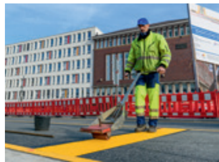
▲ Von Fahrbahnmarkierung bis zur Autobahn-Vollsperrung: Der Gerken Baustellen-Absperr-Service bietet das gesamte Spektrum, um Verkehrsströme sicher zu leiten und Baumaßnahmen durchführbar zu machen.
